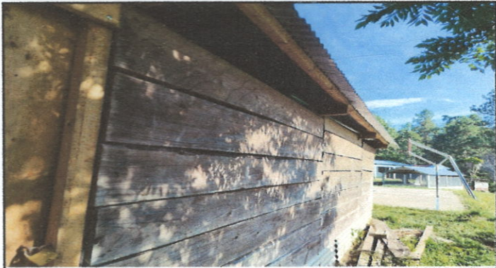
Foto1: Paredes en mal estado, No aptas
