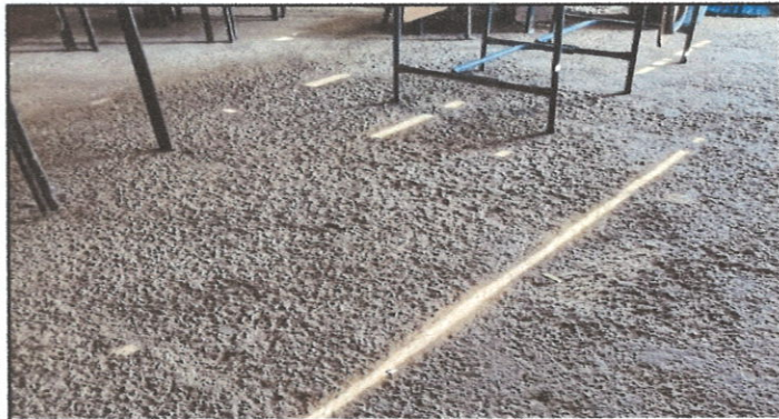
Foto 3: Piso inadecuados, inseguro y riesgos para la salud física de los estudiantes
